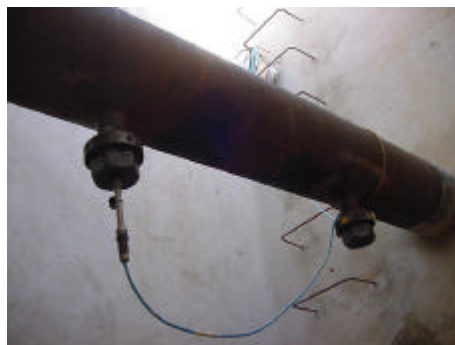
Figura 2. Caixa de Inspeção com sistemas de monitoração instalado em campo.
