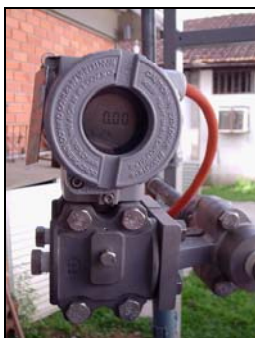
Figura 4. Sensor de vazão.
